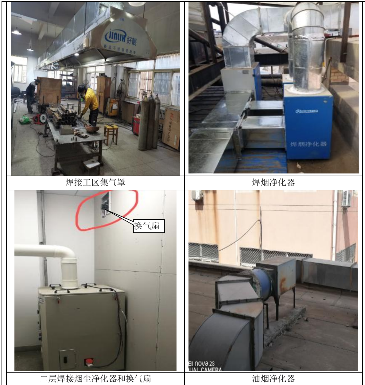
图 3-2 废气治理设施现场核查照片
