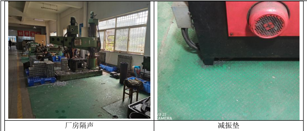
图 3-3 噪声治理设施现场核查照片
